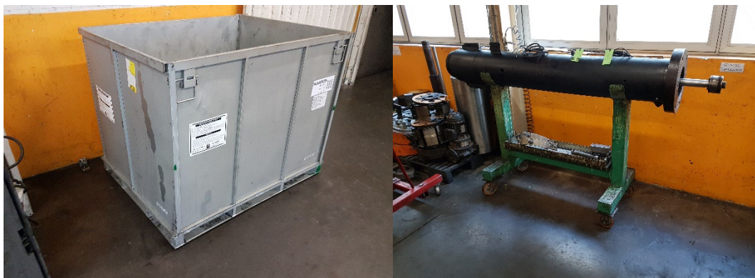
Figura 77 - Falta de marcações no chão.
