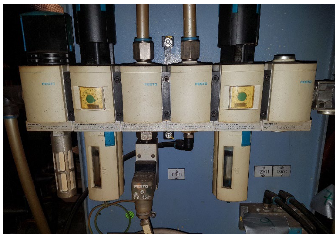
Figura 76 - Unidades de tratamento de ar utilizadas nas prensas de vulcanização (autoria própria).
