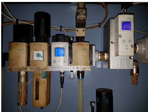
Figura 89 - Unidade de tratamento de ar comprimido MBS6 em funcionamento.
