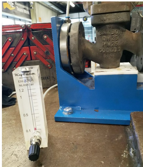
Figura 128 - Válvula por reparar com conjunto de sede e obturador em bom estado (fuga dentro dos limites estipulados).
