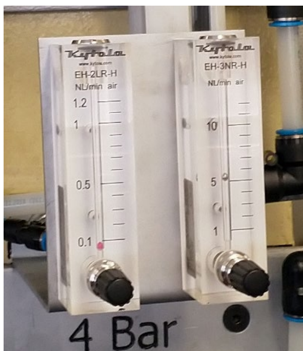
Figura 129 - Válvula reparada com excesso de fuga - nº2.
