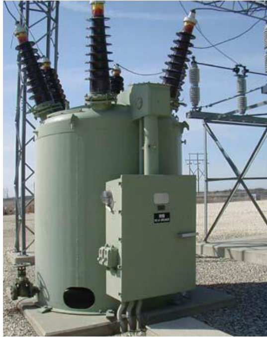
Figura 3- Disjuntor de Grande Volume de Óleo.
