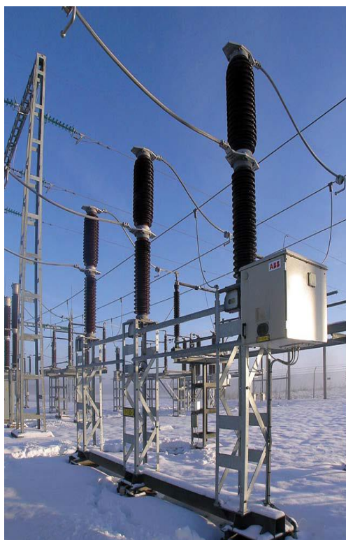
Figura 2- Configuração externa tipo Live Tank (Megger).
