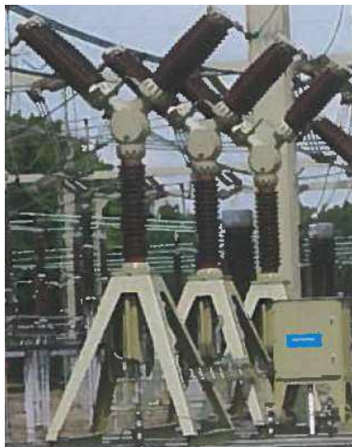
Figura 4- Disjuntor de Pequeno Volume de Óleo.
