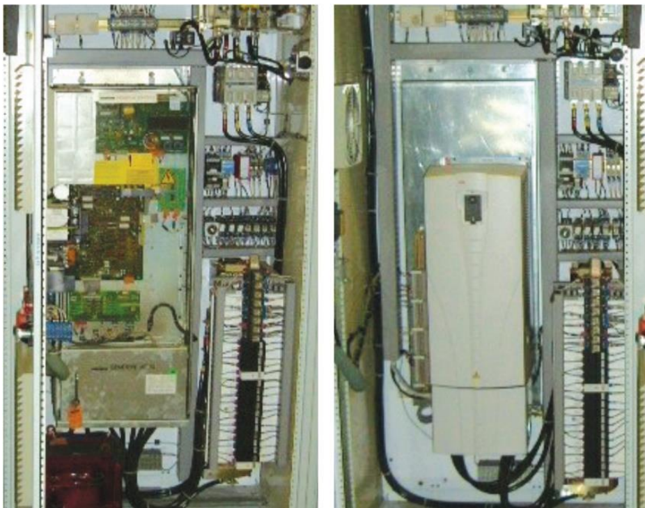
Figura 33 – À esquerda a imagem da instalação antes da substituição. À direita, após a substituição [62].
