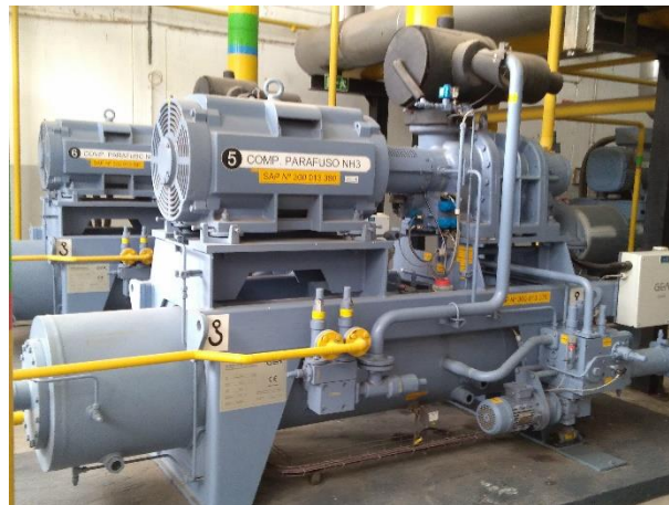
Figura 3. 10-Fotografia de um compressor de parafuso utilizado na instalação de Leça do Balio do SBG.
