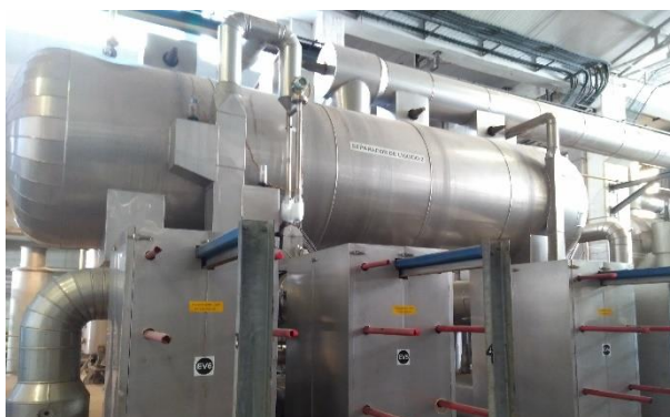
Figura 3. 12 - Fotografia de um separador de líquido e respetivos permutadores de placas acoplados da instalação do SBG.
