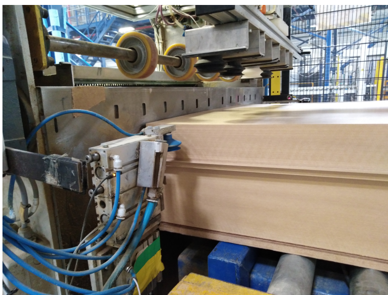
Figura 4.2: Sistema de separação de HDF na Posição 3.
