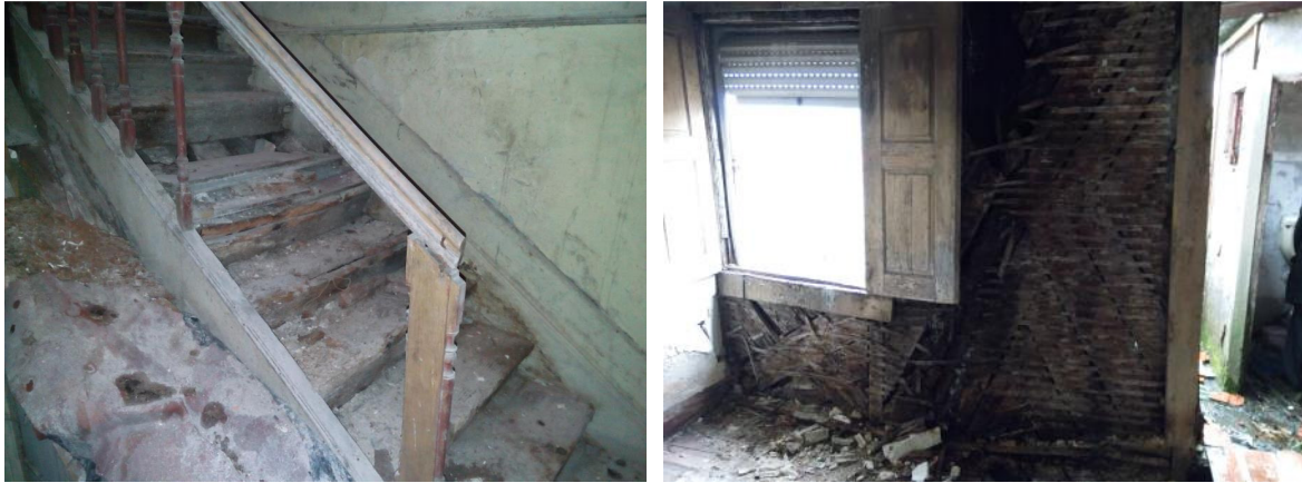
Figura 54 – Pormenor da degradação de uma das escadarias e da parede exterior em tabique do andar recuado.
