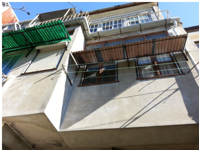
Figura 21 – Alçado posterior do imóvel antes da intervenção de reabilitação, Fev. 2014.
