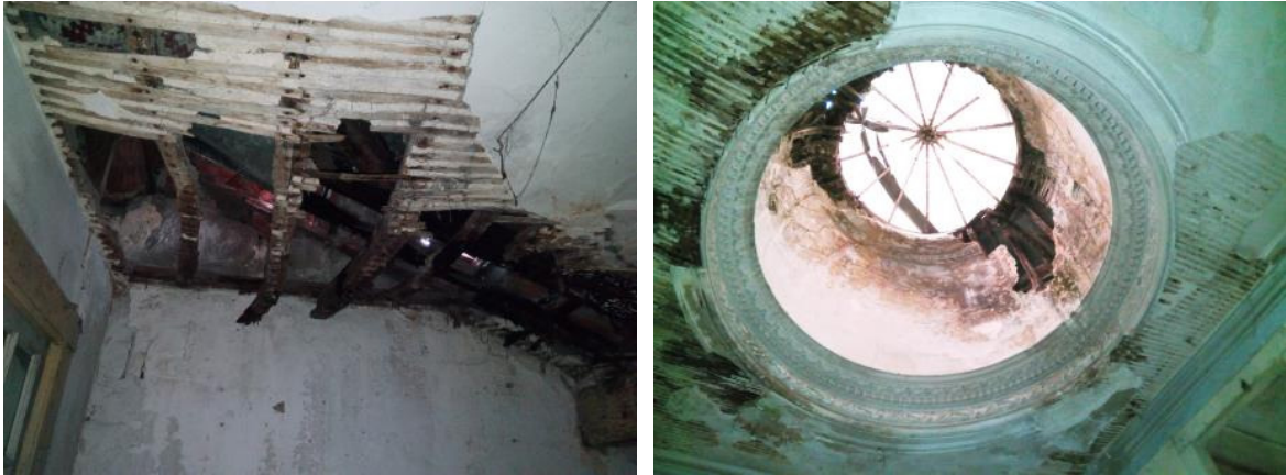
Figura 52 – Pormenor dos danos causados pelas infiltrações na cobertura e claraboia.
