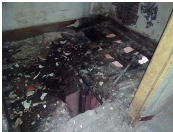
Figura 53 – Pormenor da degradação de algumas zonas dos pavimentos interiores.
