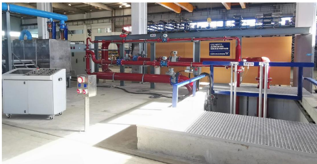
Figura 14 – Banco de ensaio de eletrobombas submersíveis de águas sujas
