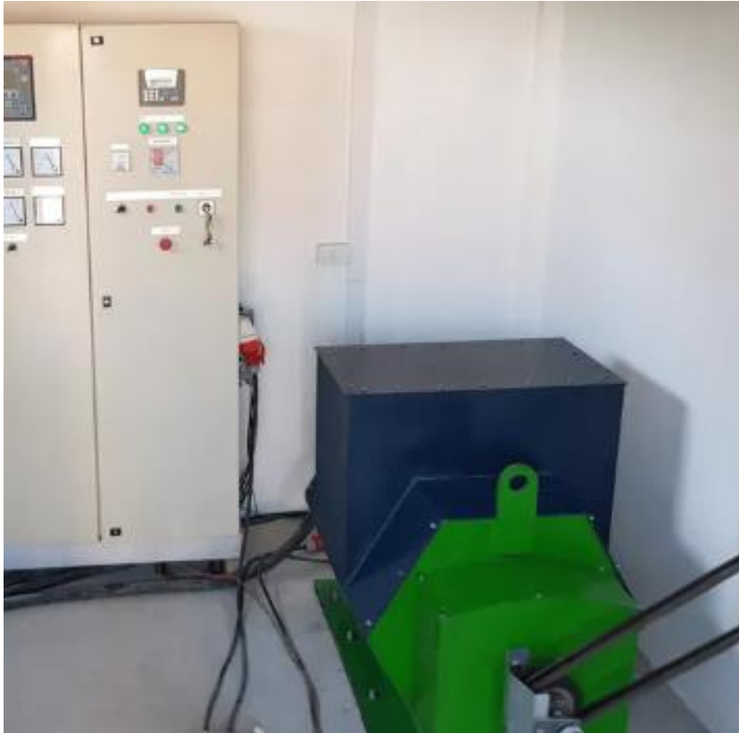
Figura 29 - KPP Quadro comando e gerador
