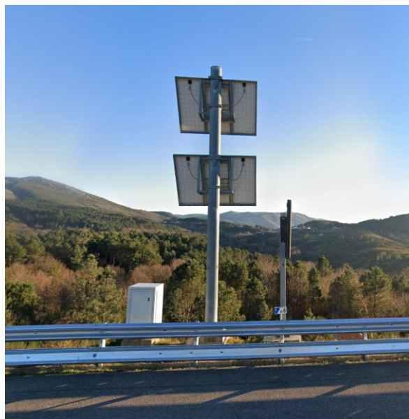
Figura 10 Estação Meteorológica Solar
