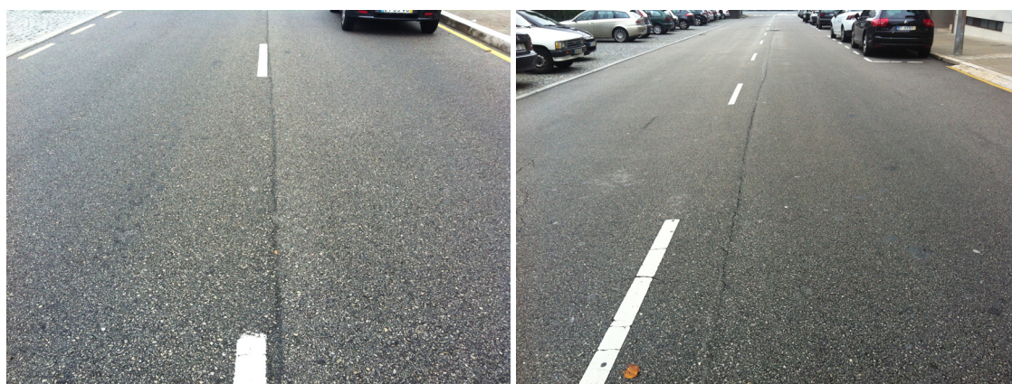
Figura 6 Fendas longitudinais: exemplos
