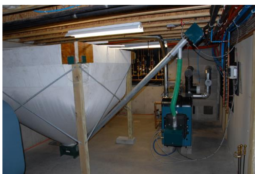
Figura 4.2 – Silo interior de armazenamento de pellets (Pellergy, 2014).
