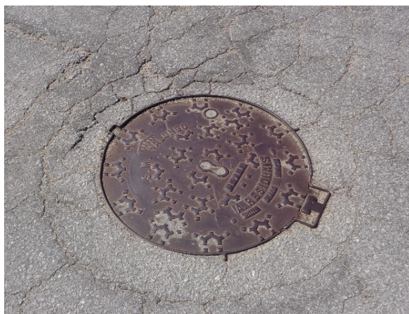
a) Tampa saneamento na Rua Central da Ribeira
