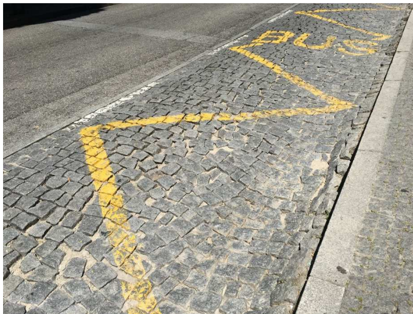
Figura 5.30 – Deformação de rodeiras longitudinais na Avenida 5 de Outubro, Valongo
