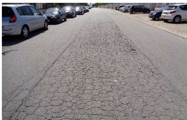
a) Degradação na estrada da Rua Central da Ribeira
