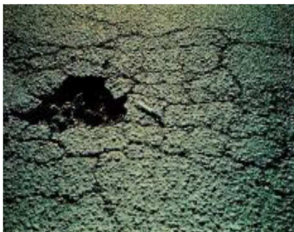
a) Desagregação superficial pormenor (TENG, 2009)
