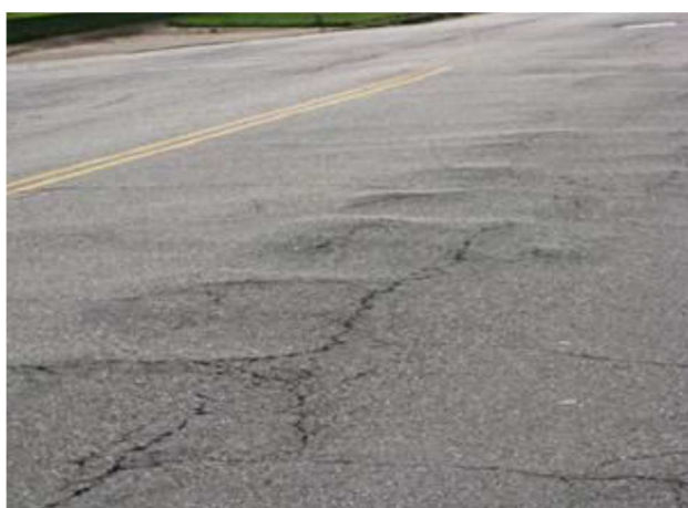
Figura 4.5 – Exemplo de uma ondulação no pavimento (VIDEIRA,2014)
