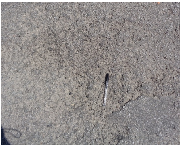
Figura 4.22 – Exemplo de uma pelada na Rua Central da Ribeira
