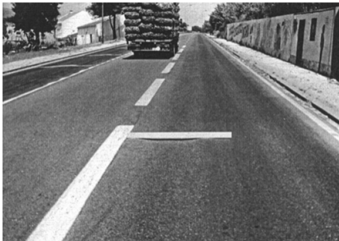
Figura 4.6 - Deformações do tipo rodeira no pavimento (LOPES, 2009)
