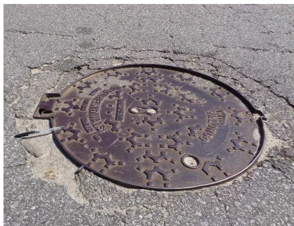
b) Tampa saneamento na Rua Central da Ribeira
