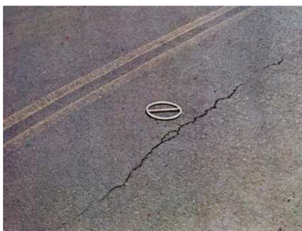
Figura 4.9 – Fendas isoladas (NORMA DNIT, 2003)
