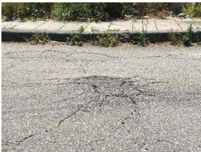
Figura 4.31 – Ondulação no pavimento, Valongo
