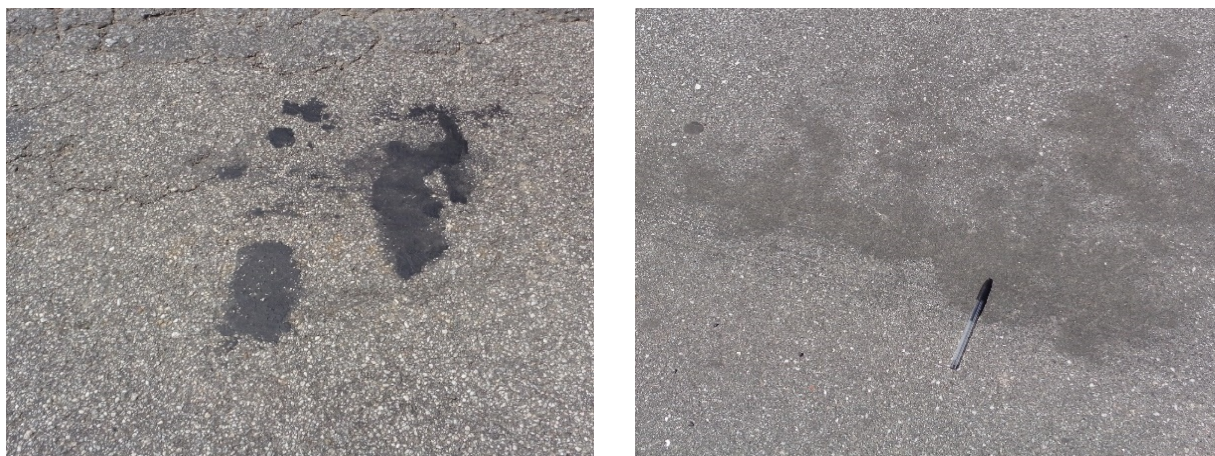
a) Exsudação na Rua Central da Ribeira (Pormenor)
