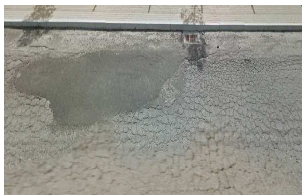
b) Degradação na estrada da Rua Central da Ribeira
