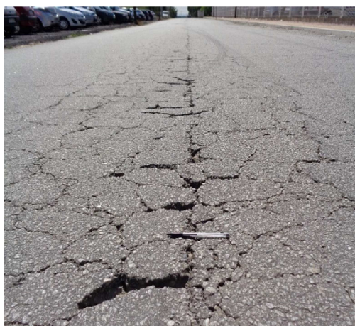
Figura 4.21 – Fenda no eixo longitudinal
