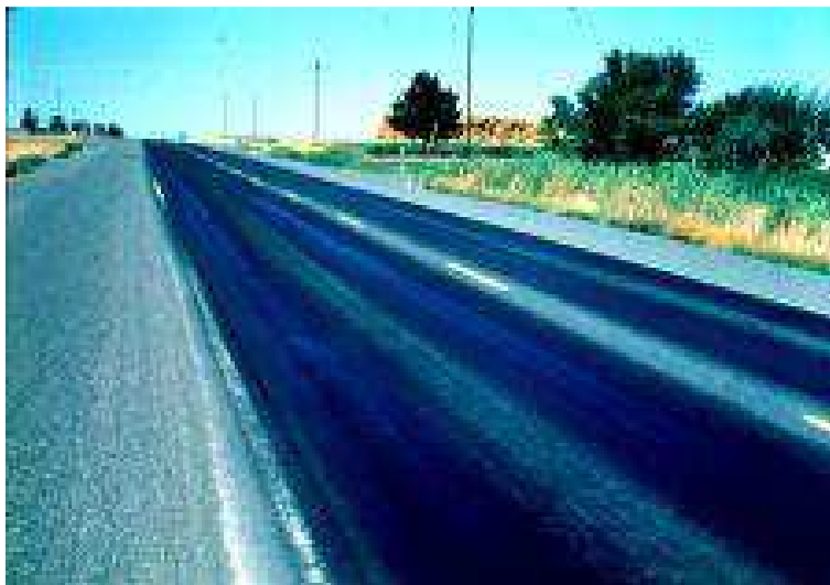
Figura 4.16 – Exemplo de exsudação no pavimento (TENG, 2009)
