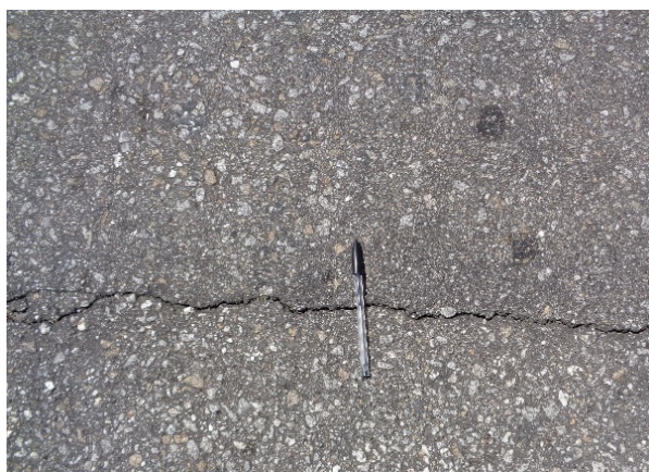
a) Fenda longitudinal Avenida Visconde de Oliveira
