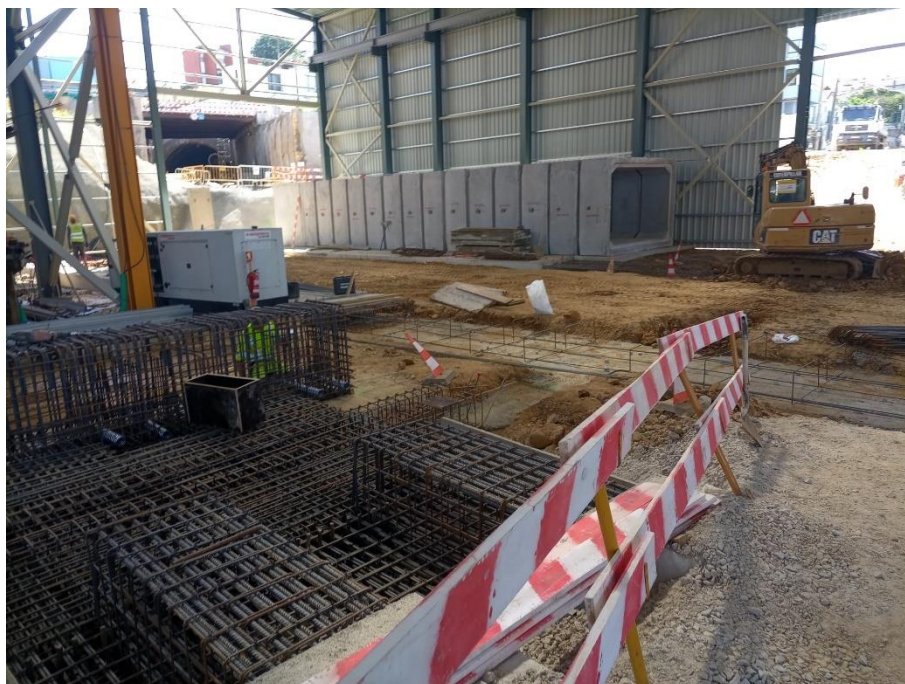
Figura 4-70 - Parque de Deslize maciço de reação e plataforma de descarga
