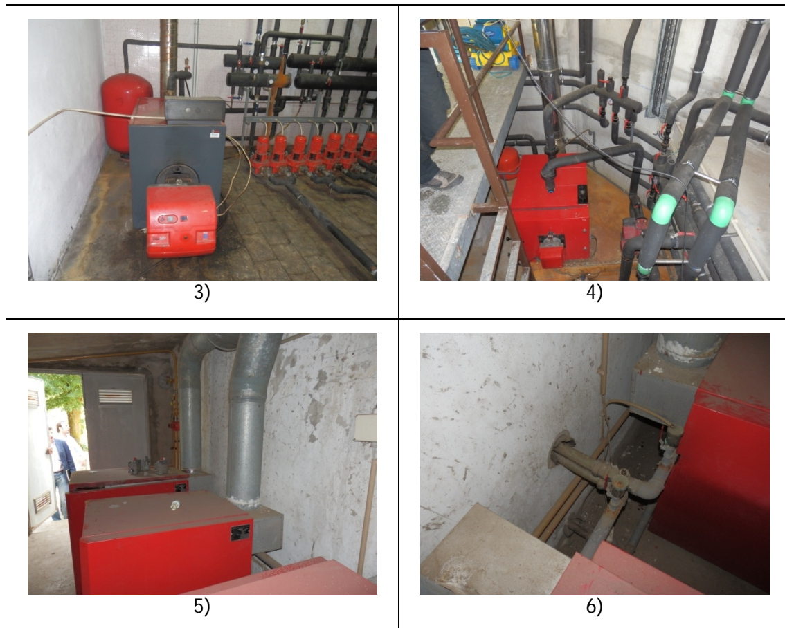
Figura 4.8 - Vista geral do estado de conservação das diferentes caldeiras
