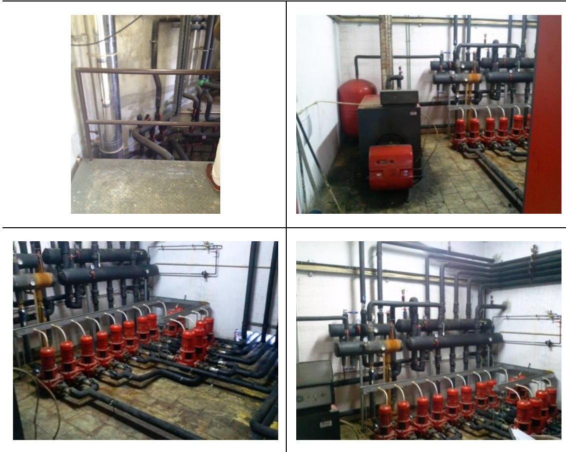
Figura 4.9 - Vista geral do estado de conservação dos acessórios das centrais térmicas. São equipamentos de apoio que já se encontram no fim do período de vida útil, o que resulta em perdas térmicas elevadas.
