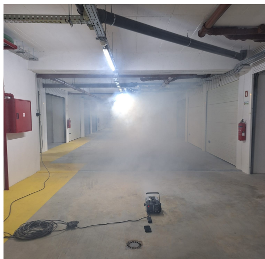
Figura 4.5: Teste com máquina de fumo no Piso -1
