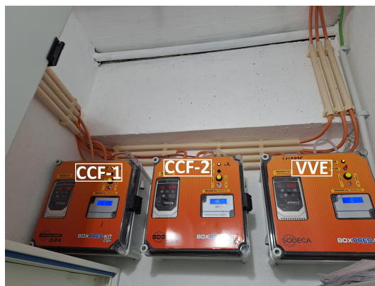
Figura 3.25: Kits de Pressurização - Pormenor de Instalação
