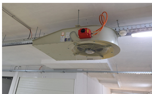
Figura 3.24: Ventilador de Impulso - Pormenor de Instalação
