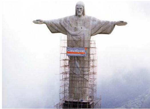
Figura 15: Primeira obra no Brasil de betão armado onde foi utilizada a malha de Titânio, com protecção catódica por corrente induzida para manutenção estrutural.
