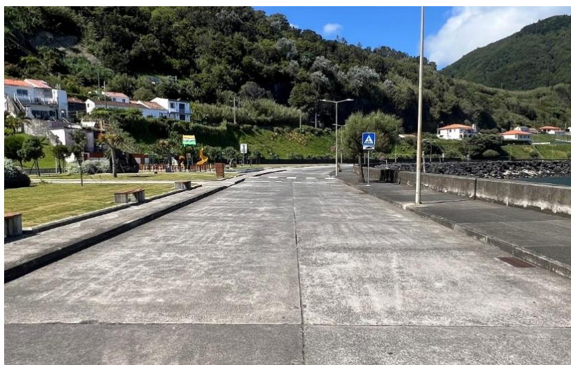
Figura 16 – Exemplo de um pavimento rígido rodoviário com as juntas visíveis, São Miguel, 2024
