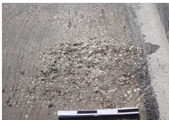
Figura 27 – Exemplo de desagregação superficial (EP, S.A., 2008)
