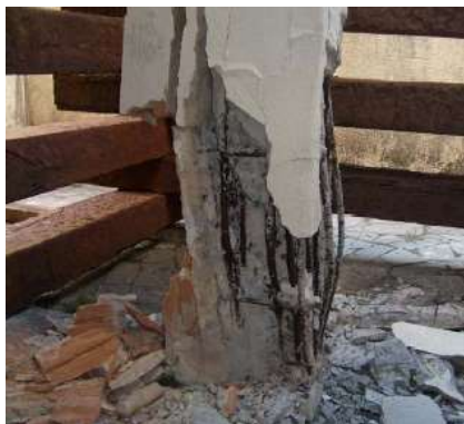
Figura 3.23 – Colapso de pilar devido à encurvadura (Camargos, 2010).
