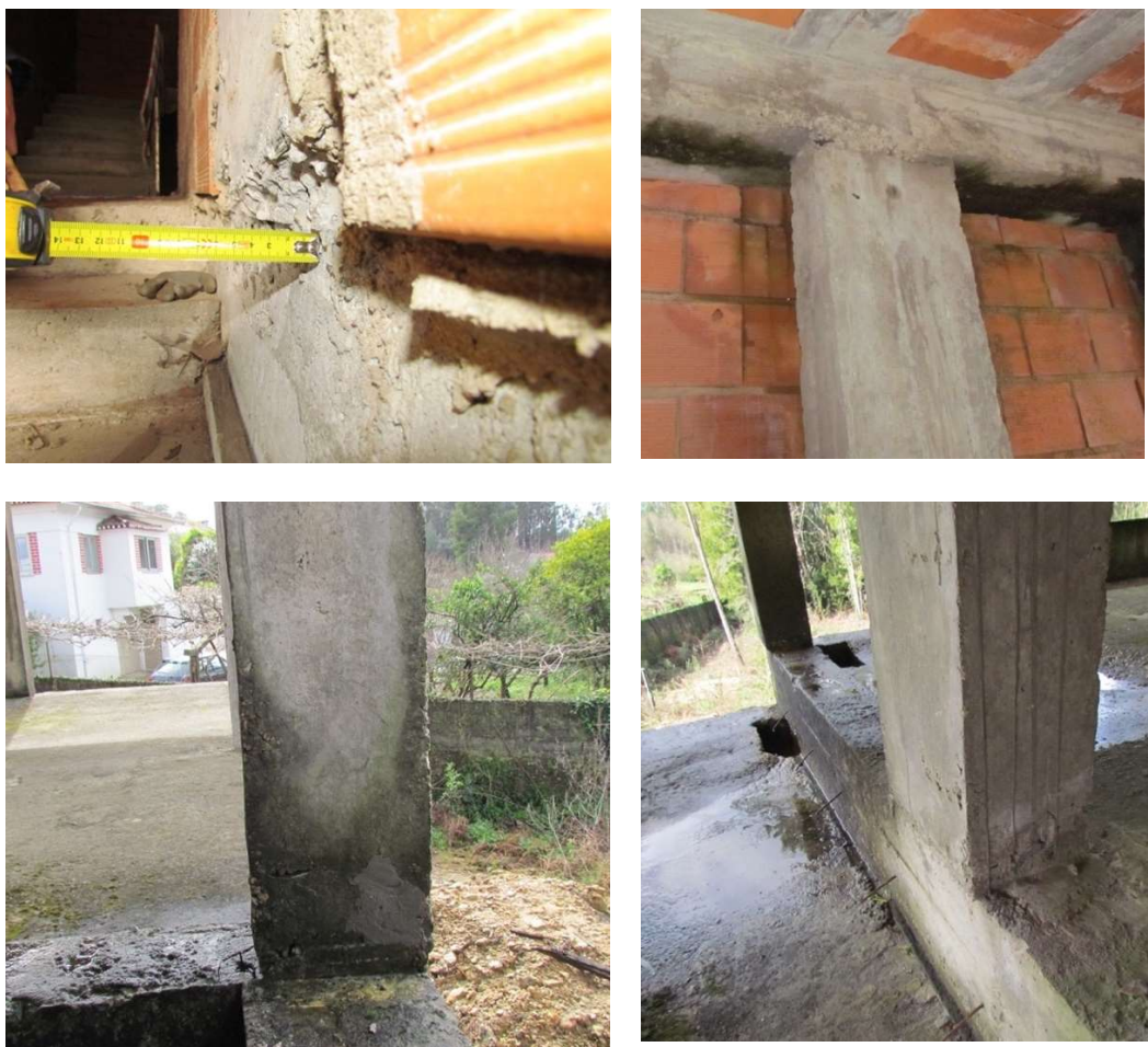
Figura 6.14 – Desalinhamento e imperfeições nos nós de ligação viga-pilar.
