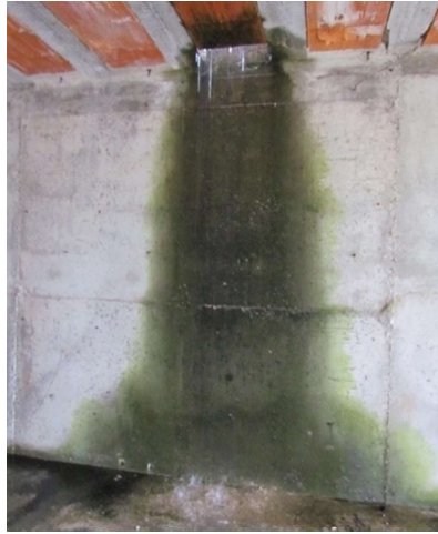
Figura 3.28 – Manchas de humidade e escorrência de água.
