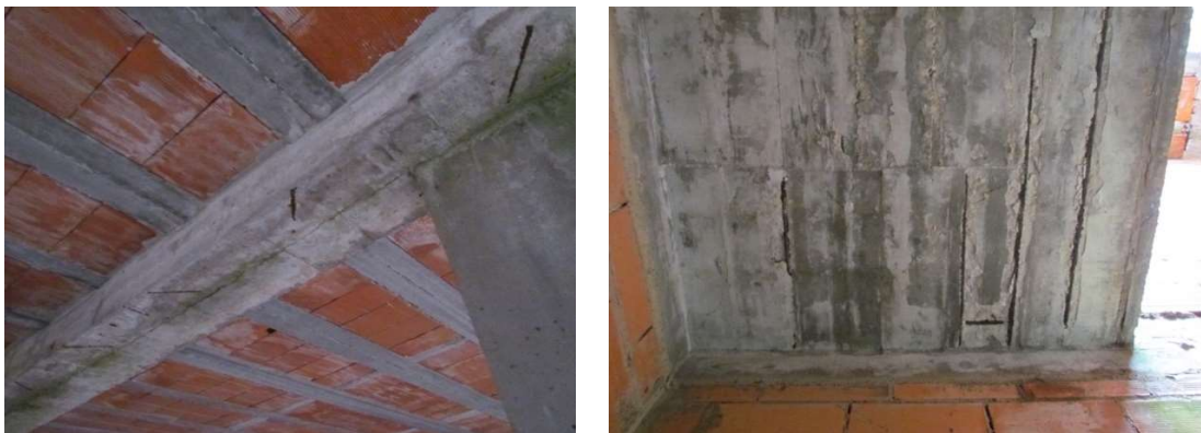
Figura 6.11 – Armadura à vista sem recobrimento em lajes e vigas.
