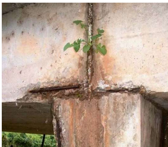
Figura 3.33 – Vegetação indesejada em elementos de betão.
