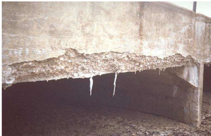
Figura 2.7 – Estrutura com degradação devido ao ciclos gelo-degelo (Costa, 2012).
