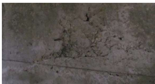
Figura 3.26 – Superfície de betão com chochos.
