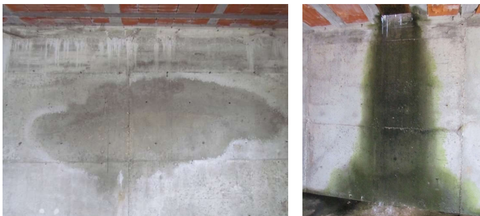
Figura 6.15 – Lixiviação do betão e escorrências de água.
