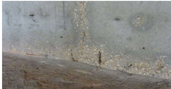
Figura 3.25 - Segregação na parte inferior da parede.
