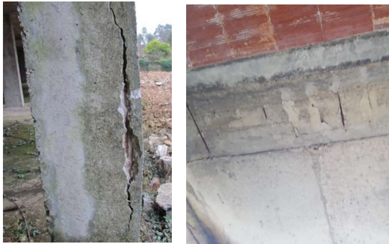
Figura 3.17 - Exemplo de elementos com delaminação e destacamento do betão.
