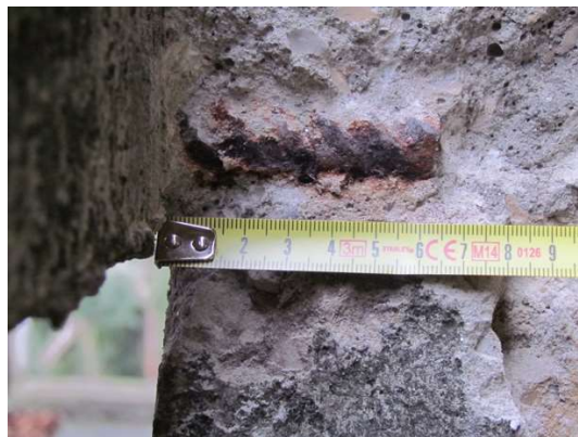
Figura 6.24 – Ligação entre patamar de escadas e pilar adjacente.
