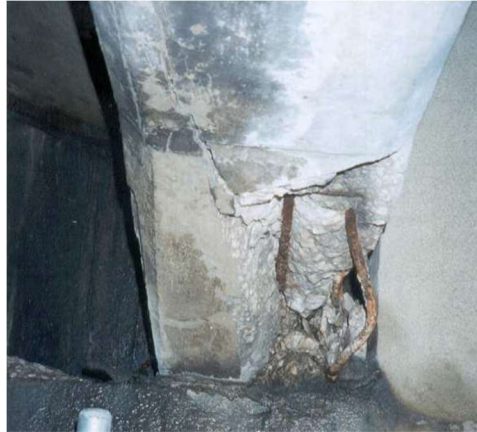
Figura 3.19 – Esmagamento de uma viga (Costa, 2012).
