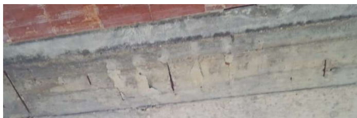
Figura 3.30 - Armadura exposta devido a recobrimento insuficiente.
