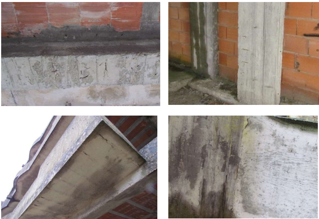
Figura 6.8 – Delaminação pontual do betão em vigas, pilares e lajes.
