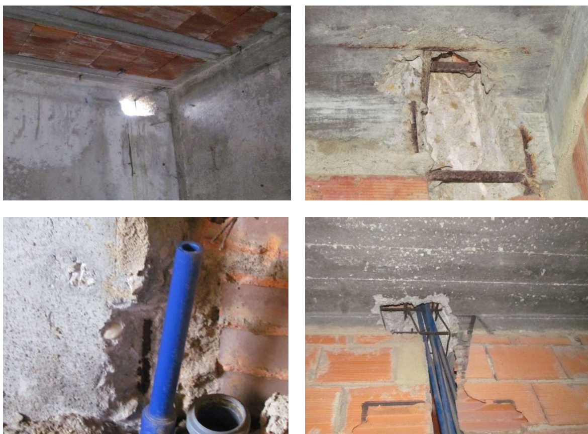
Figura 6.16 – Aspeto construtivo com interferência na durabilidade.
