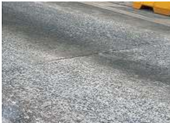
Figura 2.2 - Pavimento com sinais de abrasão (Abreu, 2010).
