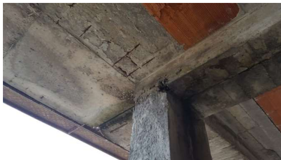
Figura 3.29 – Viga com armadura à vista com sinais de corrosão.
