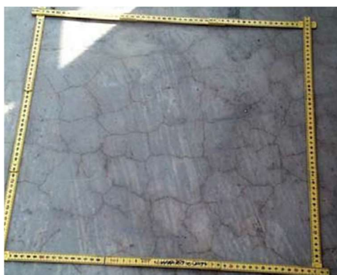
Figura 3.8 – Fissuração devido a retração plástica (EP, 2006).
