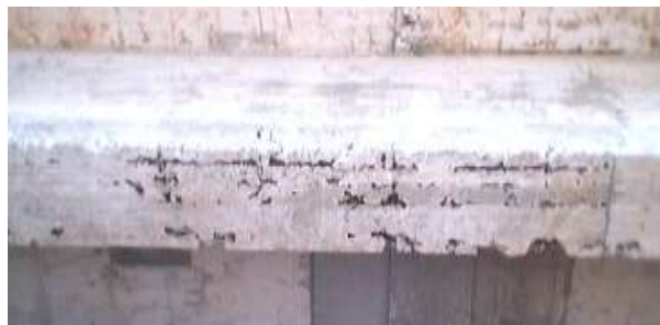
Figura 3.31 - Segregação do betão, devido a armadura muito próxima (Moraes, 2016).
