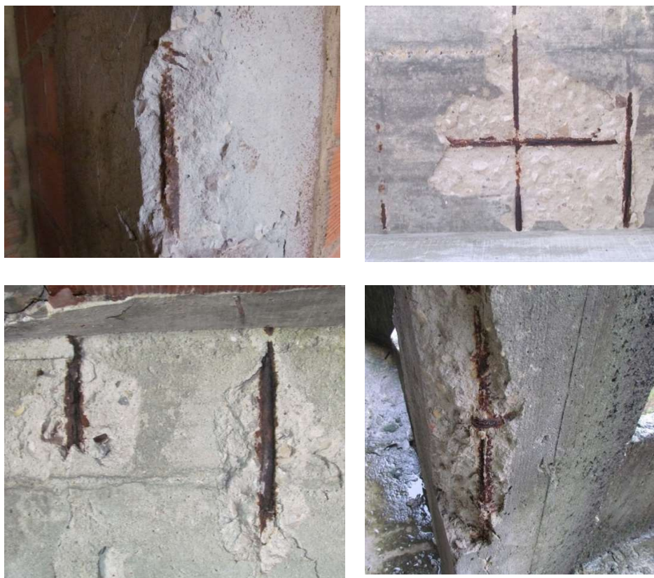
Figura 6.10 – Corrosão da armadura com perda de secção.
