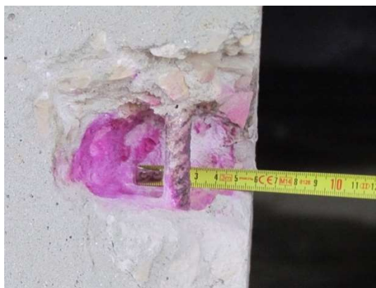
Figura 5.21 - Profundidade de Carbonatação.
