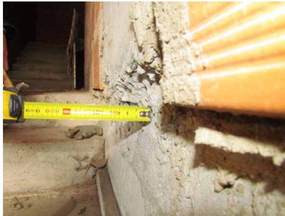
Figura 3.22 - Desalinhamento de pilar em relação a viga.
