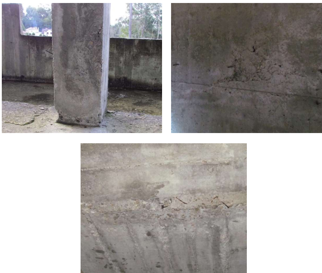
Figura 6.13 – Vazios, ninhos de brita e porosidade em pilares, vigas e paredes.
