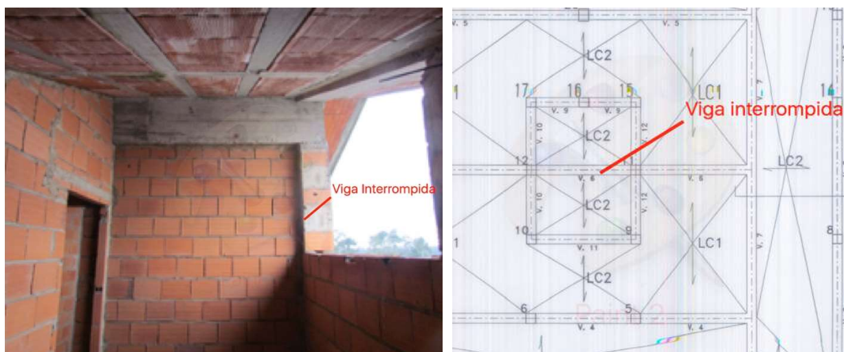
Figura 6.7 - Viga interrompida e ausência de apoio na cobertura do Bloco 5.
