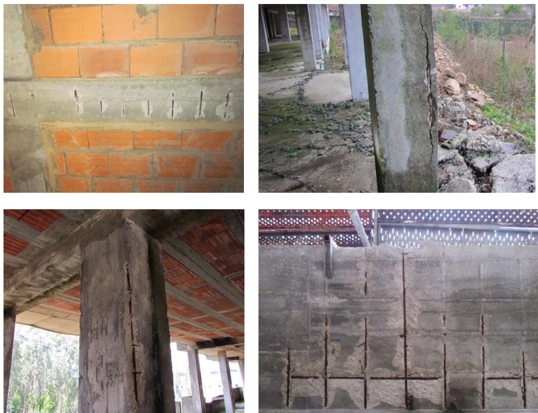
Figura 6.9 – Delaminação extensa do betão em pilares, vigas e lajes.
