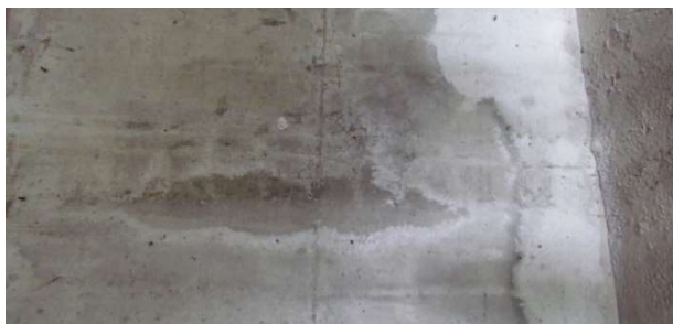
Figura 3.27 – Parede com sinais de lixiviação.
