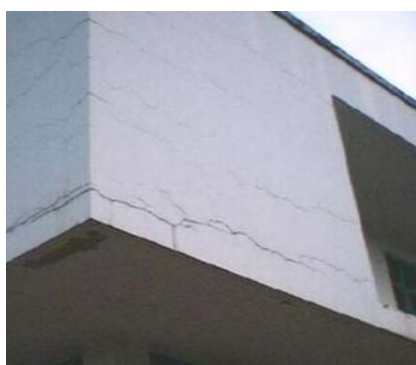
Figura 3.21 – Deformação excessiva de corpo em balanço ( odrigorcarvalho.com.br/artigos/patologias-em-concreto-armado/ ).
