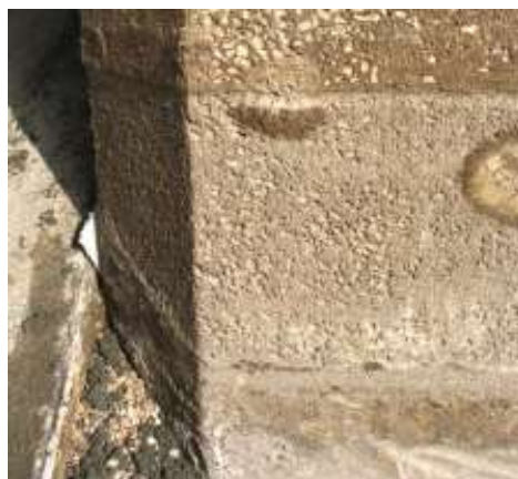
Figura 3.20 – Deterioração da camada superficial do betão devido à passagem de água (Costa, 2012).
