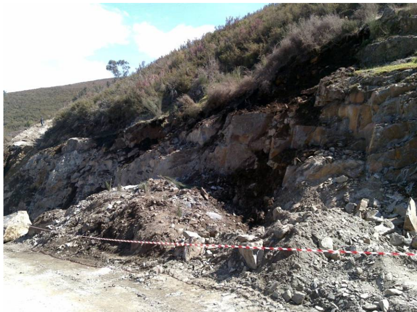
Figura 78 – Obra onde ocorreu infra escavação: necessário recorrer a desmonte posterior (Castro de Aire).
