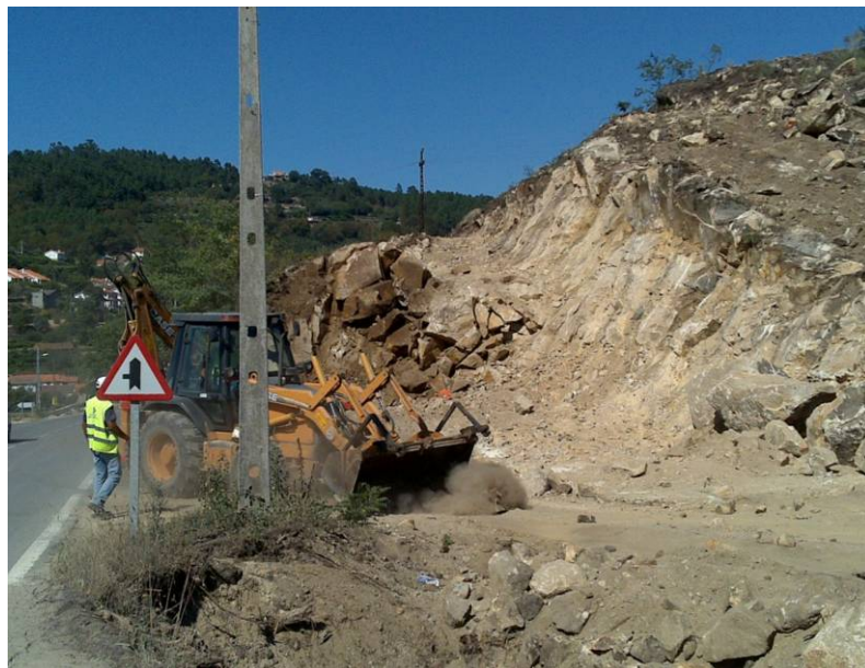
Figura 76 – Obra onde a rotura não teve continuidade segundo o plano predefinido (São Pedro do Sul).
