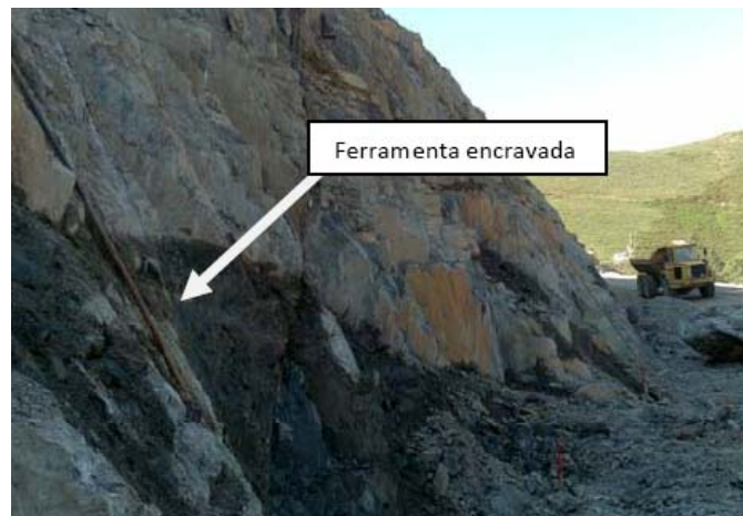
Figura 49 – Ferramenta de perfuração encravada/perdida.
