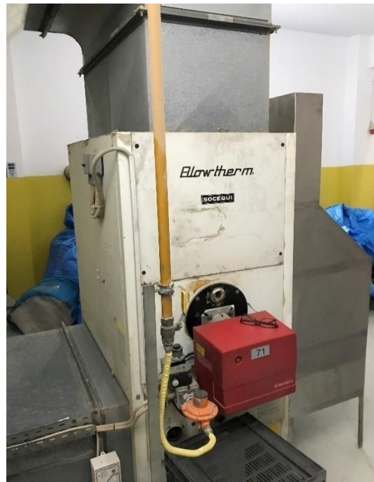
Figura 5.6- Gerador de ar quente utilizado na J.A. Beira.
