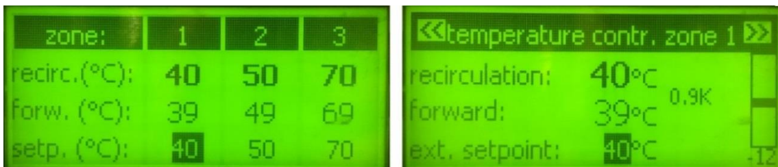
Figura 4.6 - Painel de Controlo da TCU.
