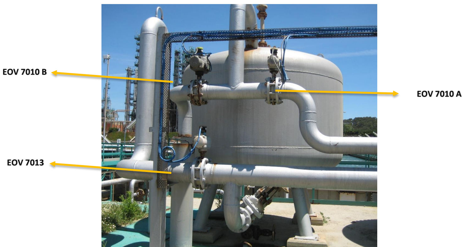
Figura 3.11 - Detalhe do filtro de areia F-7002 A e do conjunto de electroválvulas que regulam o funcionamento deste filtro.
