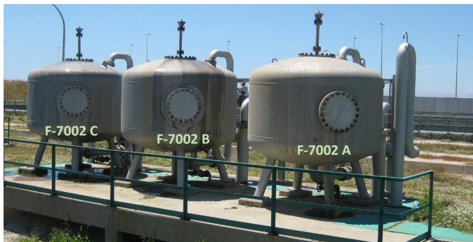
Figura 3.10 - Conjunto de filtros de areia do tratamento terciário da ETARI da Refinaria de Matosinhos.
