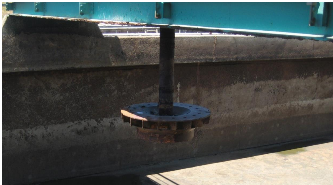
Figura 5.12 - Fotografia de um dos arejadores de superfície instalado no tratamento biológico I.
