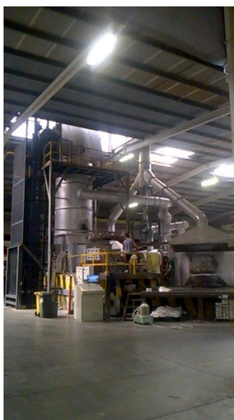
Figura 21 - Chaminés com extração forçada das hotes dos fornos de espera.
