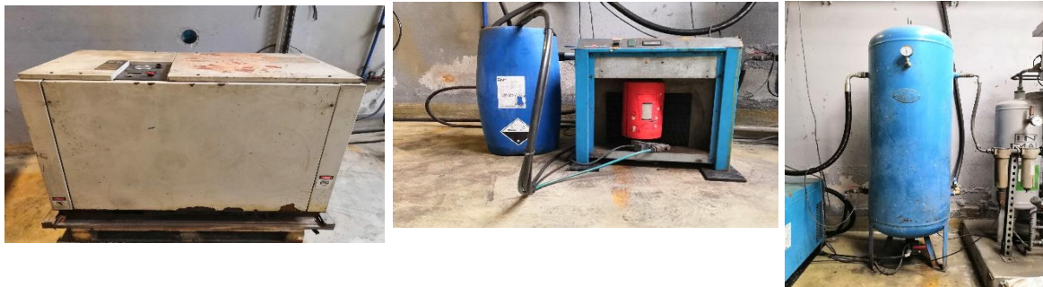
Figura 5.7- Compressor da marca Ingersoll Rand e secador e reservatório adjacentes.
