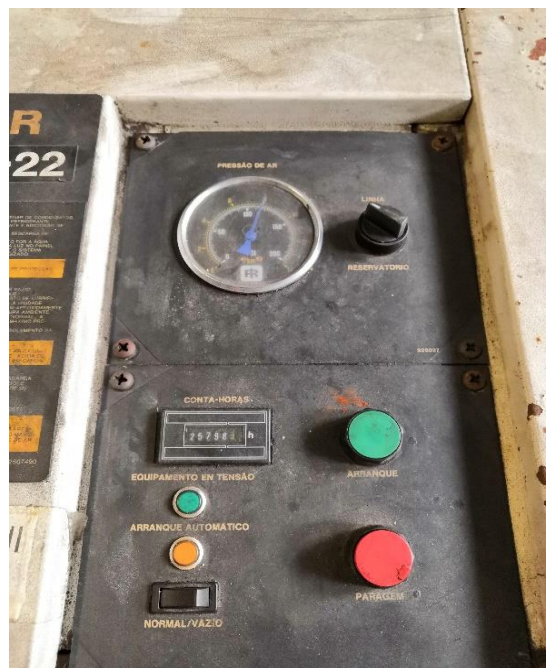
Figura 5.10- Barómetro do compressor 1.
