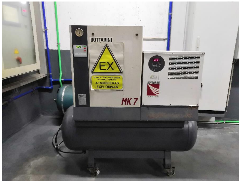
Figura 5.8- Compressor da marca Bottarini e secador, montados em cima do reservatório.
