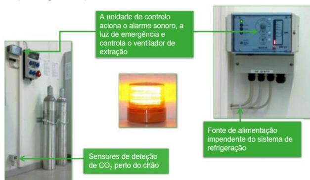
Figura 11 – Sistema de alarme de fugas de CO 2 (Adaptado) [29]
