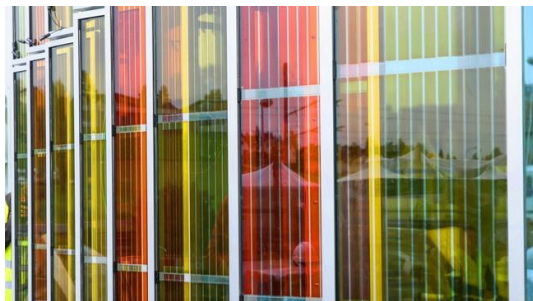
Figura 11 - Implementação de DSC na fachada do Centro de Convenção SwissTech [52].
