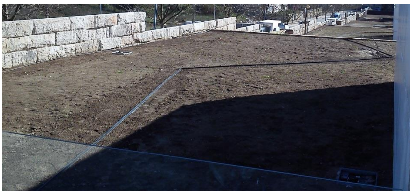
Figura 5.9 – Falta ripado do pátio inglês.
