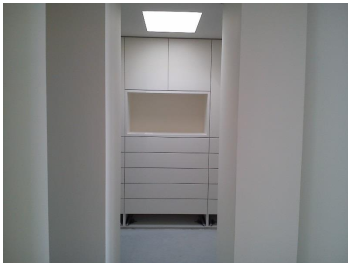
Figura 5.18 – Gavetas em falta.
