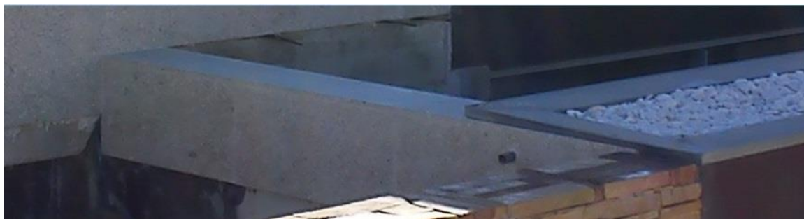
Figura 5.12 – Rufo mal executado.
