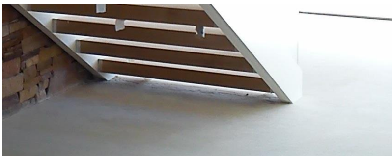
Figura 5.15 – Falta acabamento no pavimento.
