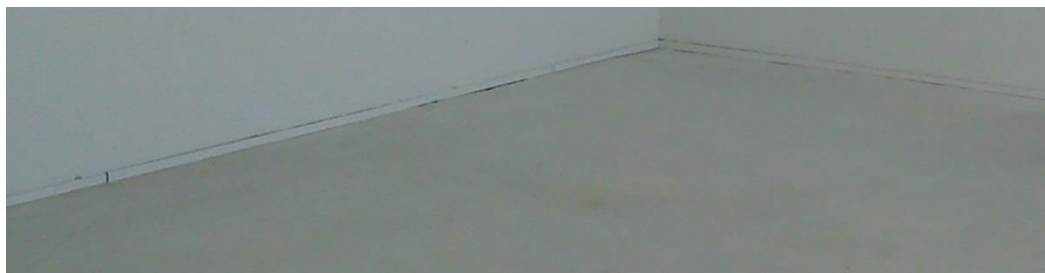
Figura 5.16 – Buraco junto ao rodapé da sala.
