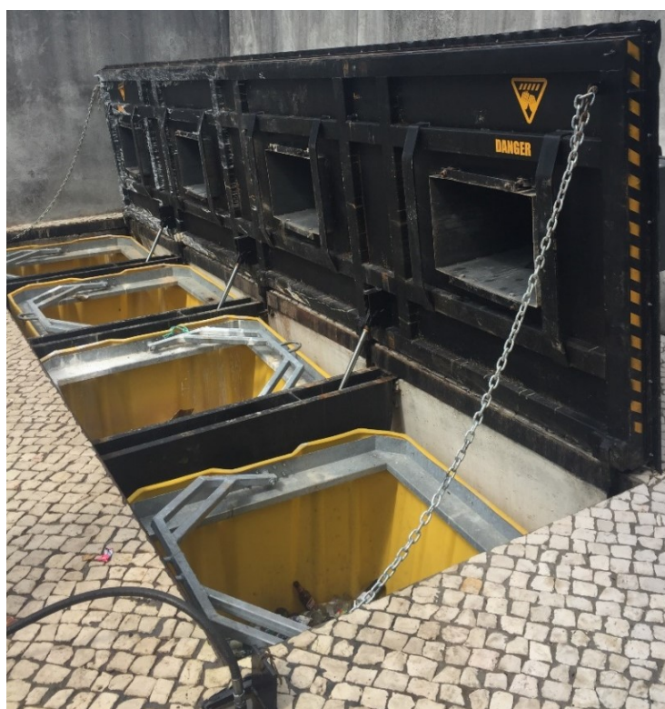
Figura 86 - Vista do equipamento HS4 com a tampa aberta.
