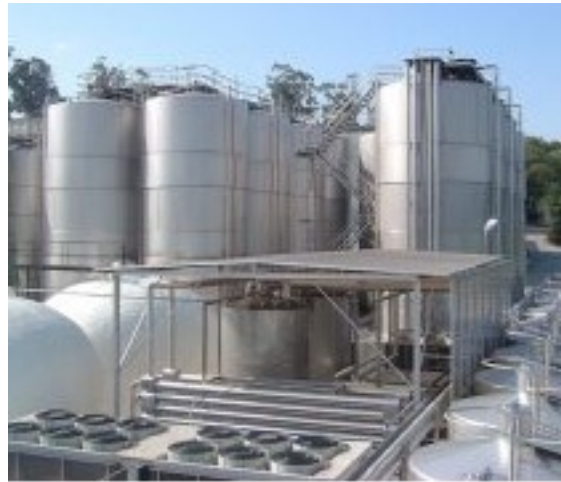
Figura 9 - Exemplo de instalação de equipamentos em aço inoxidável na Indústria Alimentar (Arsopi, 2019).
