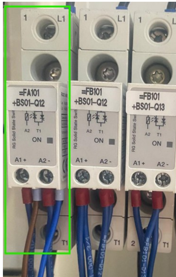
Figura 26 - Relé FA101+BS01-Q12, que controla o comando de aquecimento da resistência
