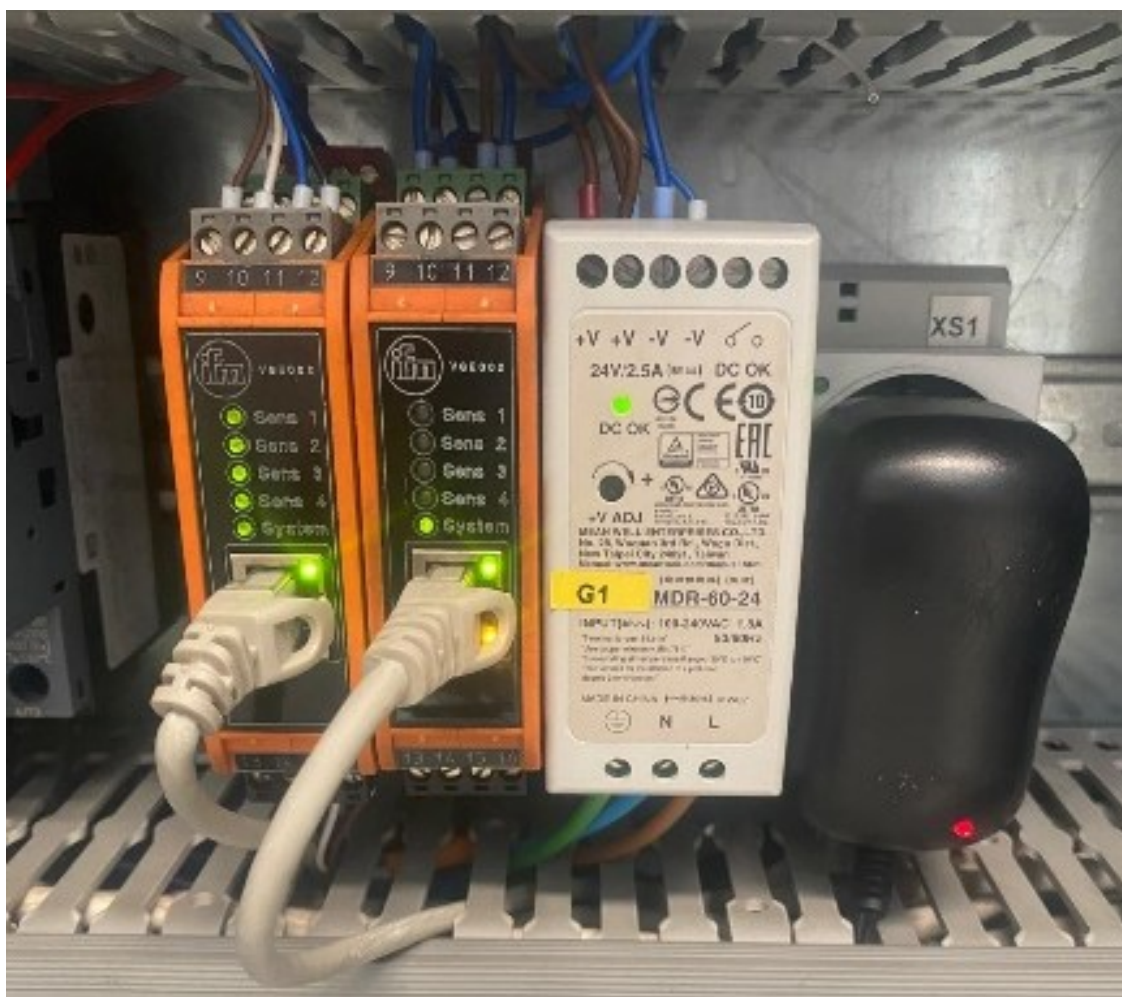
Figura 29 - Instalação das ferramentas de diagnóstico VSE002_1, VSE002_2 e da fonte de alimentação dedicada FA1
