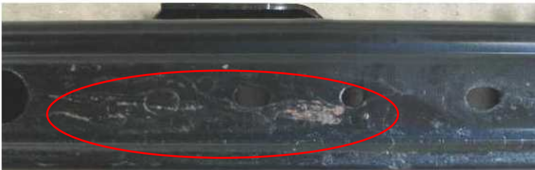
Figura 46 – Exemplo de Oxidação
