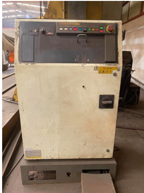
Figura 40 - Controlador FANUC SYSTEM R-J3
