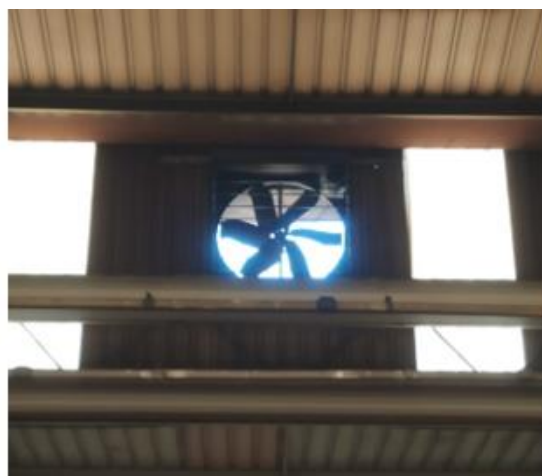
Figura 134 - Representação da ventilação forçada existente em chão de fábrica
