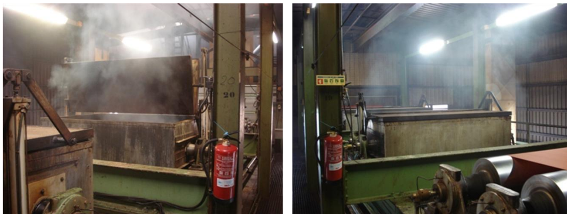
Figura 4.9 – Fuga de gases de combustão e exaustão pelo topo das estufas da máquina Zell
