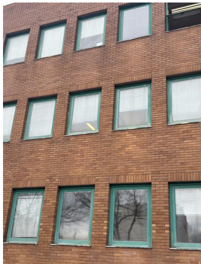
Figura 16- Janelas com proteção solar interior do edifício
