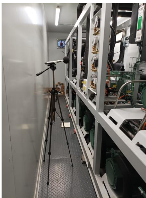
Figura 54 - Medição na casa de máquinas (Caso 2)
