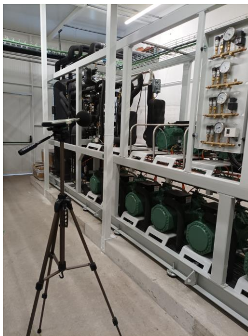
Figura 46 - Medição na casa de máquinas (Caso 1)
