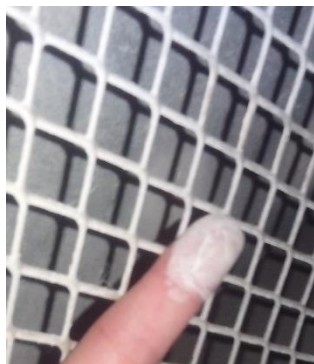
Figura 5.1- Sujamento presente na entrada de ar para aquecimento da olaria
