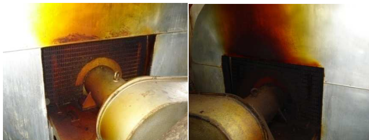
Figura 30 – Fotografias dos ventiladores de exaustão
