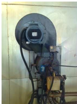
Figura 20 – Ventilador da estufa 5
