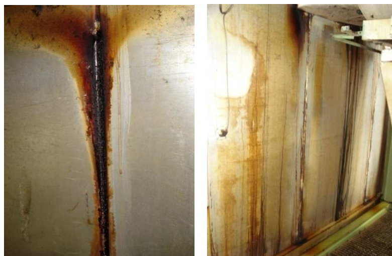
Figura 26 – Fotografias das junções de placas das estufas
