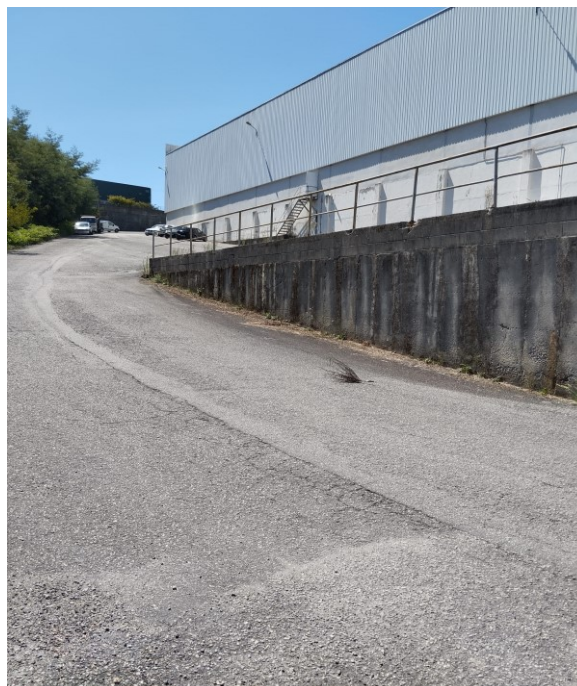
Figura 4 - Vista do fundo da fábrica que mostra o desnível
