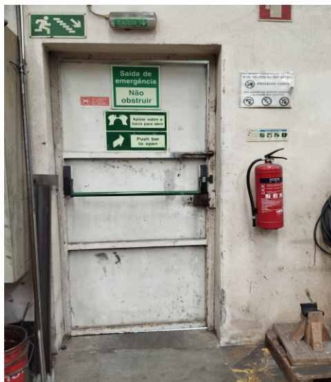
Figura 13 - Saída de emergência da zona de produção
