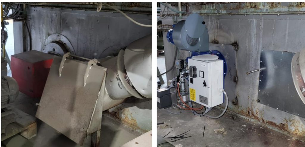
Figura 35 - Queimador antigo (esquerda) e novo queimador modulante instalado (direita)
