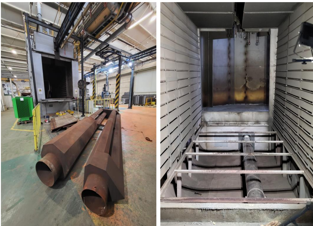
Figura 36 - Câmara de combustão antiga (esquerda) e novo tubo de distribuição de gases (direita)
