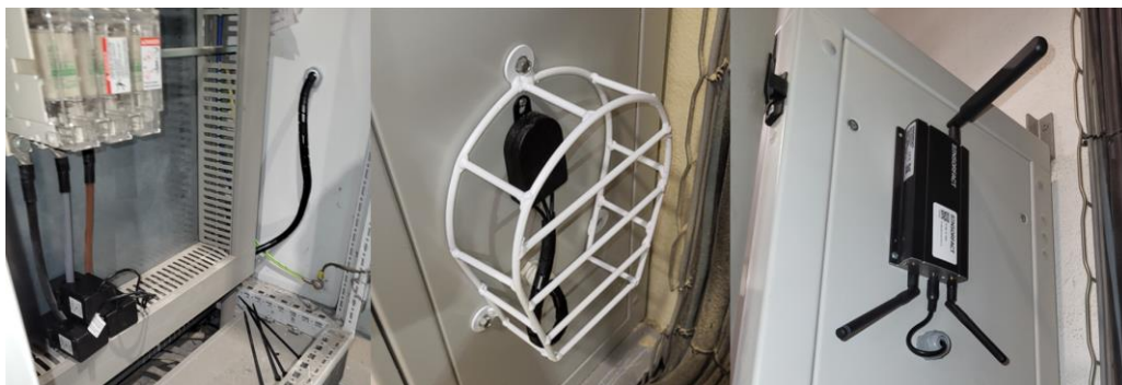
Figura 17 - Exemplo de instalação concluída com power analyser e bridge de comunicação da Sensorfact
