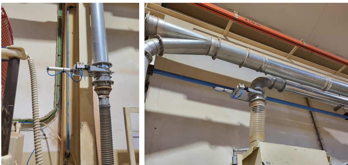
Figura 30 - Instalação de novas válvulas guilhotina em ramais de aspiração no Despoeiramento do Core
