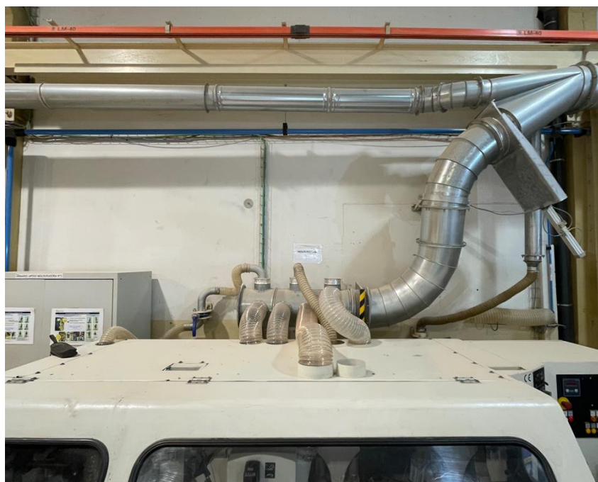
Figura 24 - Exemplo de uma válvula guilhotina pneumática instalada num ramal de extração
