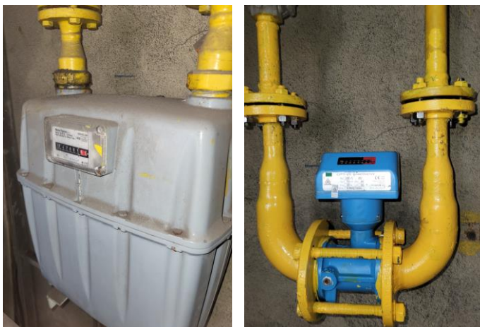
Figura 16 - Contador de gás analógico antigo (esquerda) e novo contador digital com saída de impulsos (direita)
