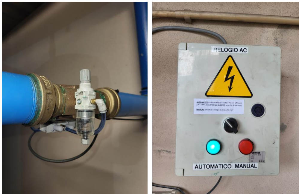
Figura 28 - Válvula de corte e quadro de controlo do sistema do SAC da Maia
