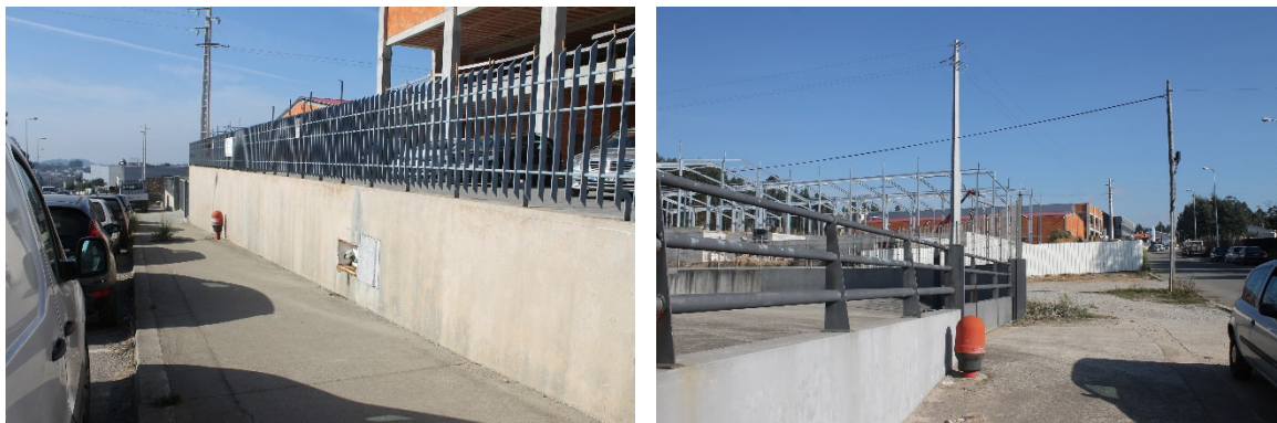
Figura 31 e 32 – Hidrantes Exteriores
