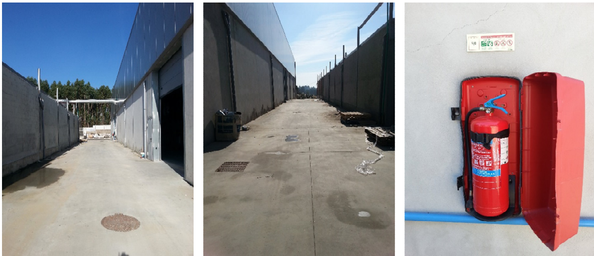
Figura 26, 27 e 28 – Reservatório enterrado e extintor
