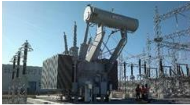
Figura 2 - Transformador de potência
