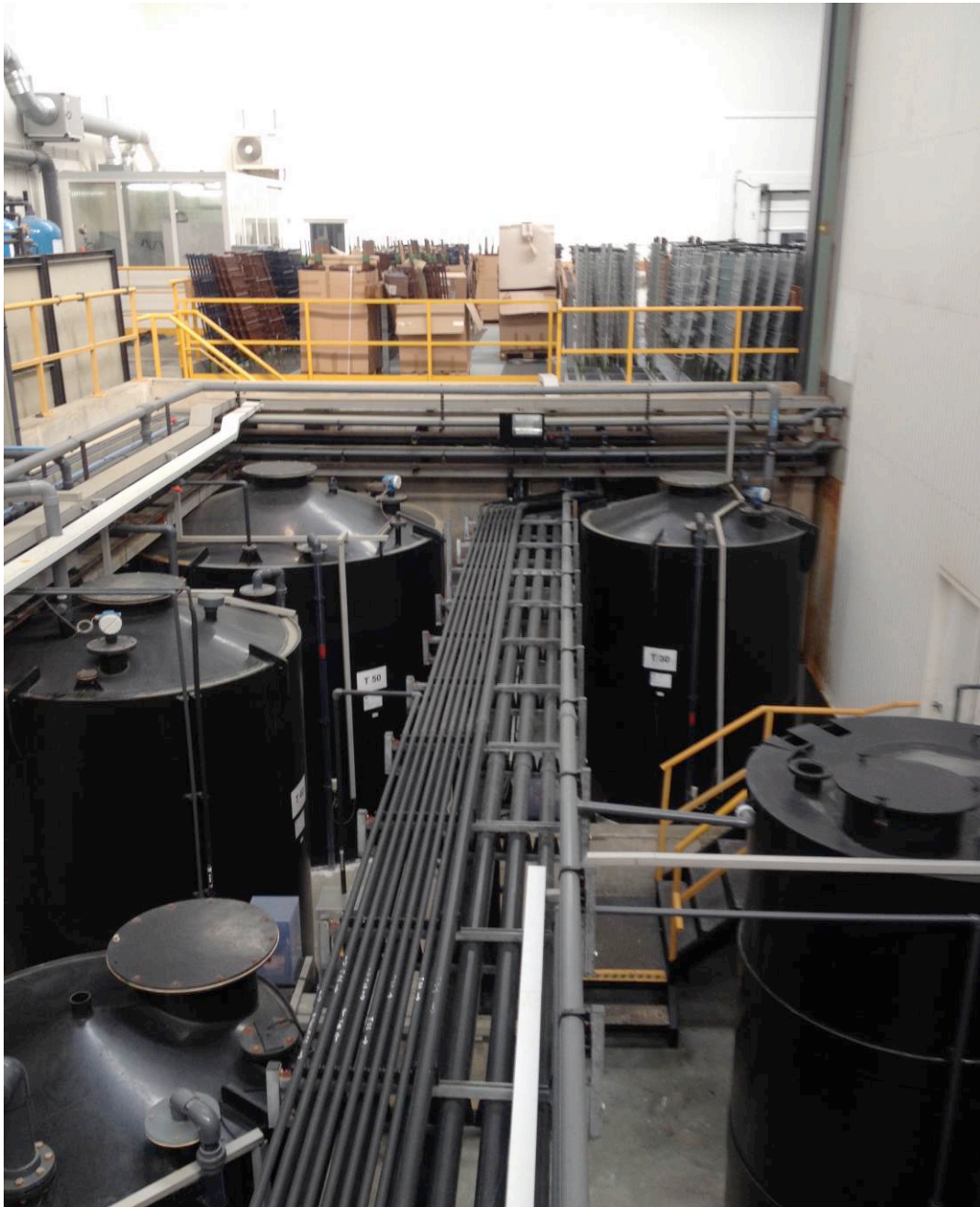
Figura 3.1 – Caminho de cabos
