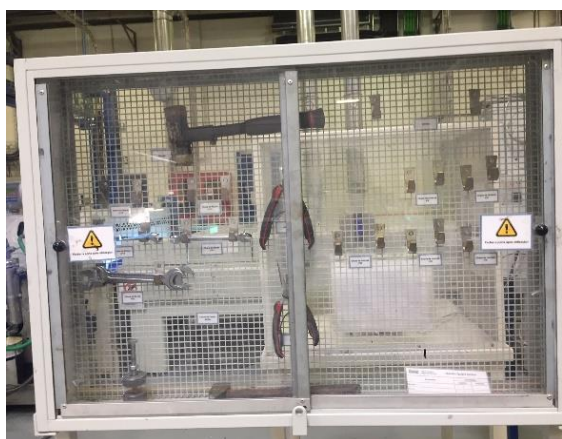
Figura 43 - Novo quadro sombra.
