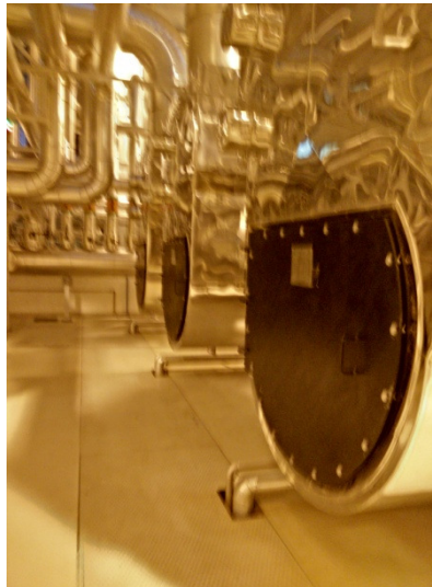
Figura 5- Caldeira de recuperação de vapor
