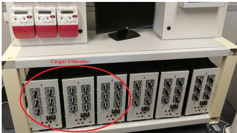
Figura 17 - Cargas resistivas de 4kW.
