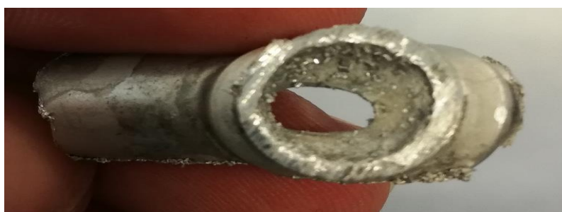
Figura 72 – Parte do tubo cortado na zona da válvula (Empresa em estudo).
