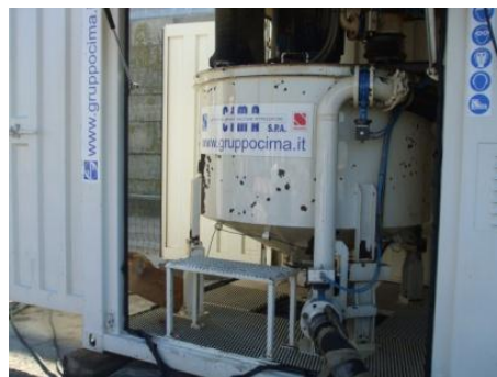
Ilustração 127 - Central de cimento
