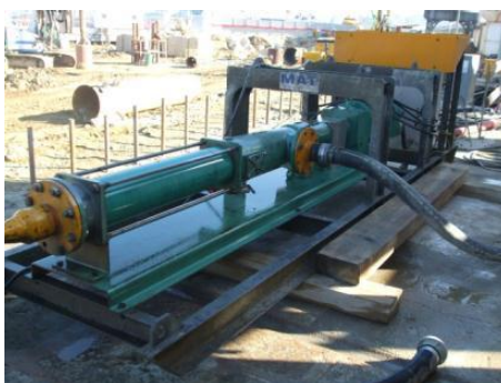
Ilustração 128 - Bomba de injeção de calda de cimento
