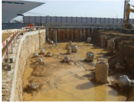
Ilustração 134 - Inundação em obra devido a falha de uma bomba
