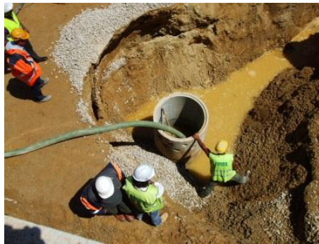
Ilustração 135 - Aluimento devido à drenagem de um poço
