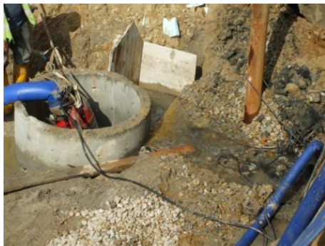
Ilustração 136 - Bomba em funcionamento
