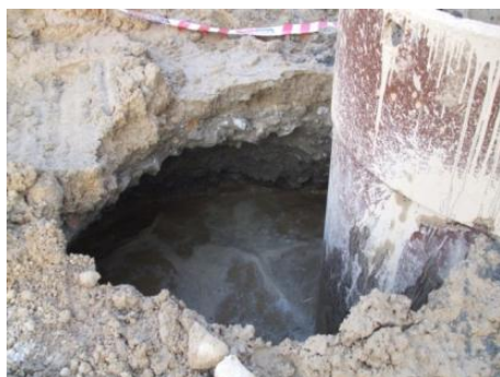
Ilustração 49- Colapso do terreno em volta da estaca
