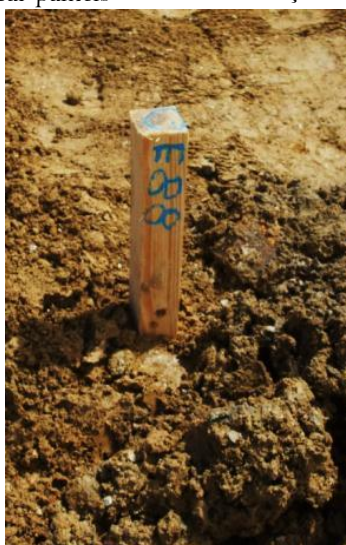
Ilustração 83 - Estaca de sinalização
