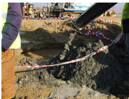
Ilustração 56 - Estaca assoreada betonada com betão pobre
