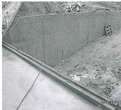
Figura 4.31 – Falta de guarda-corpos
