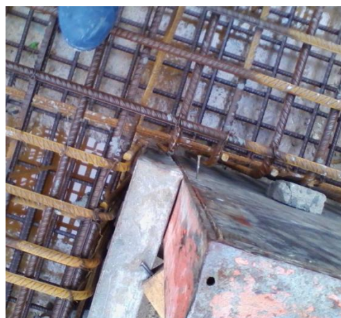
Figura 4.26 – Armadura de laje sem recobrimento
