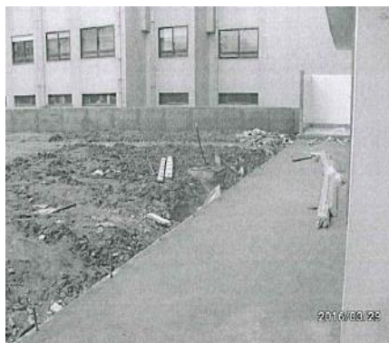
Figura 4.32 – Ferros em espera sem proteção
