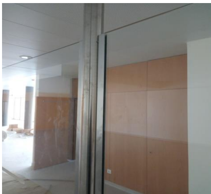
Figura 4.17 - Biombo no piso -1 não conforme com o projeto - EMPREENDIMENTO 1
