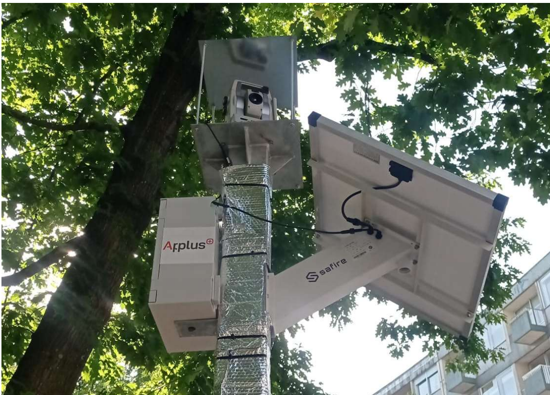
Figura 11- Estação Total automatizada instalada numa torre, com alimentação elétrica através de um painel solar.
