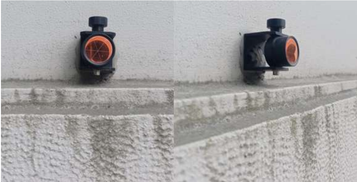
Figura 13- Prisma topográfico em habitação.
