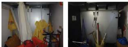
Figura 42 – Acesso ao Equipamento Condicionado por Material Inapropriado à Zona Técnica
