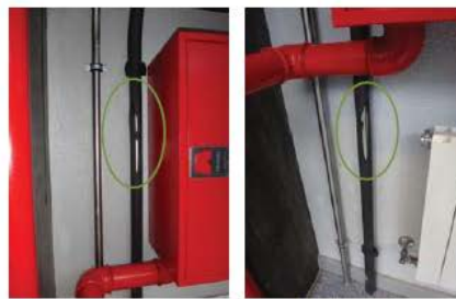
Figura 40 – Defeitos no Isolamento de Tubagens
