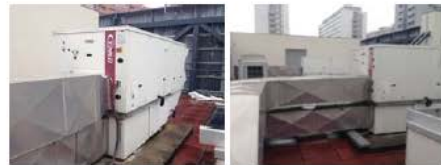
Figura 5 – Unidades Rooftop Instaladas na Cobertura
