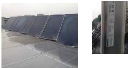
Figura 41 – Sistema Solar Térmico
