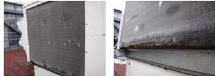
Figura 39 – Dissipador de Rooftop
