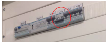
Figura 17 – Iluminação Exterior Desativada
