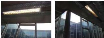
Figura 43 – Iluminação Artificial em Funcionamento na Presença de Franca Iluminação Natural
