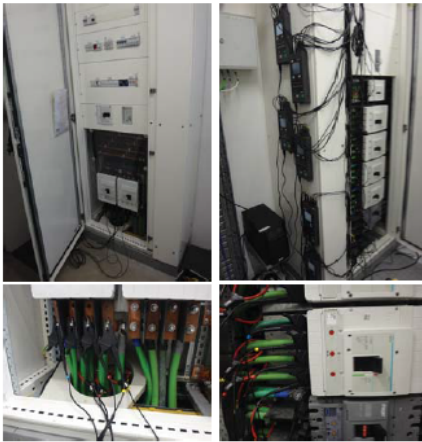
Figura 14 - Exemplos de Medições Efetuadas nos Quadros Eléctricos
