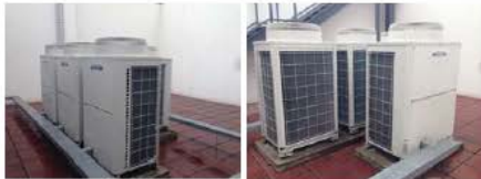
Figura 4 – Exemplo de VRV Instaladas na Cobertura
