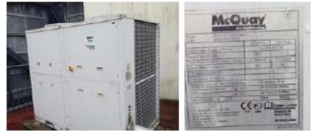
Figura 3 – Chiller Instalado na Cobertura
