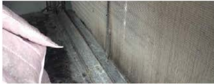
Figura 38 – Vestígios de Infiltrações e Corrosões no Interior da UTA
