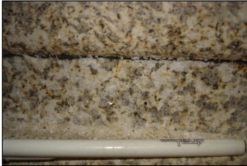
Figura 35 – Desagregação granular de intensidade forte – Capela (Maio, 2007).
