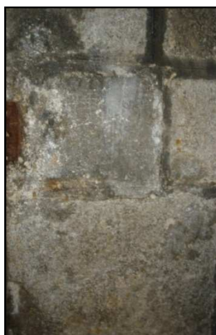
Figura 38 – Eflorescência do tipo fluffy – Sacristia (Maio, 2007).
