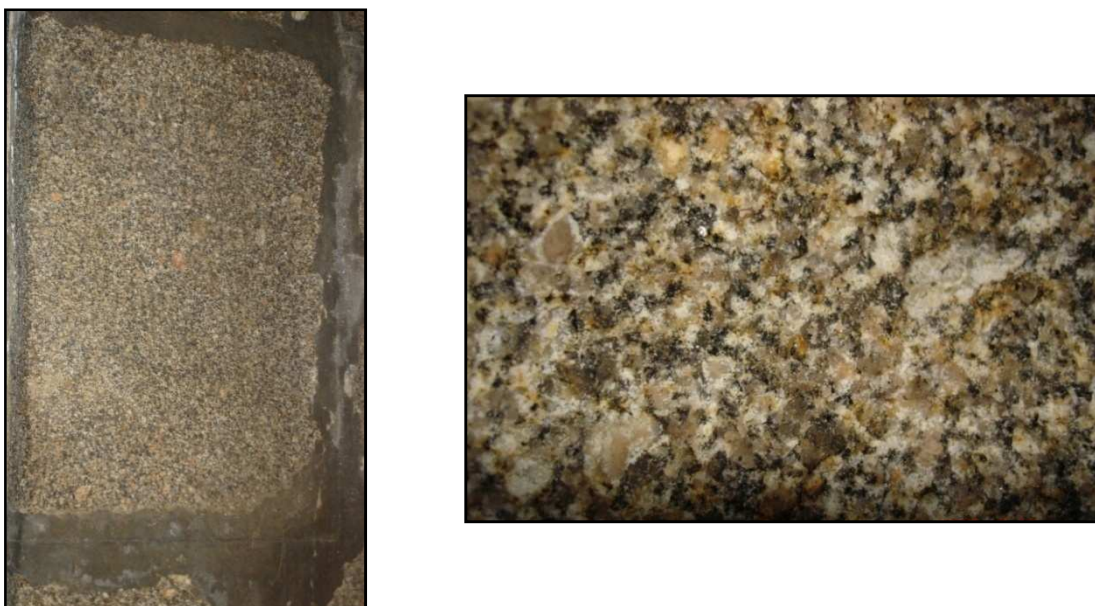
Figura 36 – Desagregação granular de intensidade forte – Sacristia (Maio, 2007).
