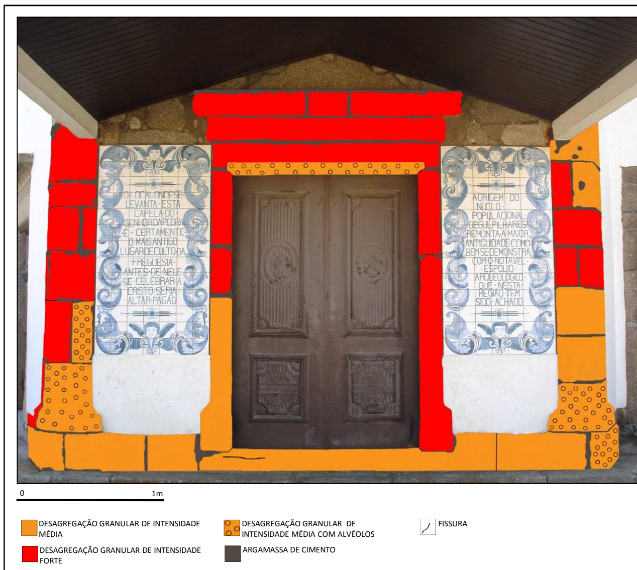
Figura 41 - Cartografia das deteriorações existentes na porta principal da Capela do Senhor da Pedra orientada a Este.
