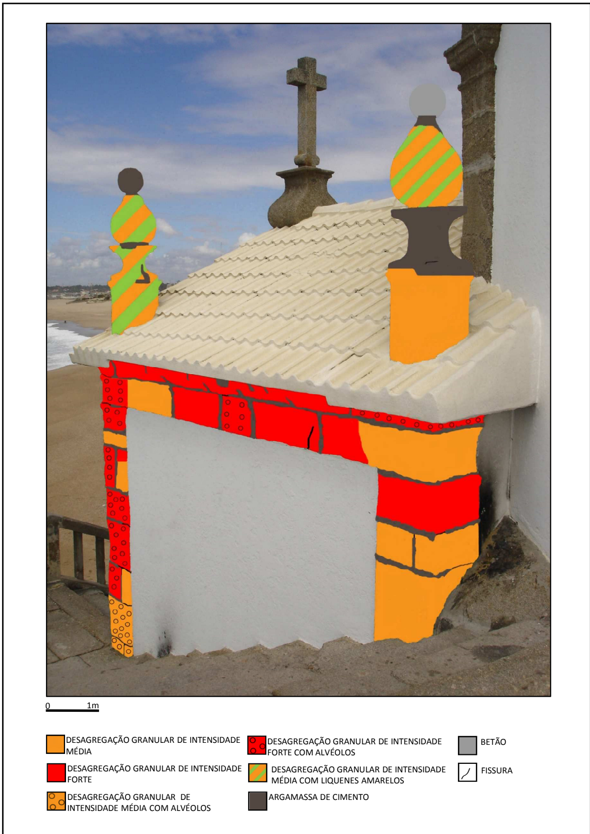
Figura 1 – Cartografia das deteriorações existentes na fachada Oeste da Capela do Senhor da Pedra.
